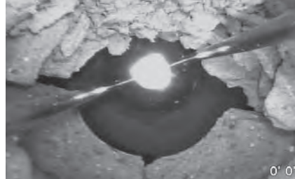
Figura 13 – Agujero que atravesó una alcantarilla
